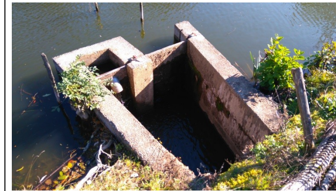
Trop plein (type moine avancée)
