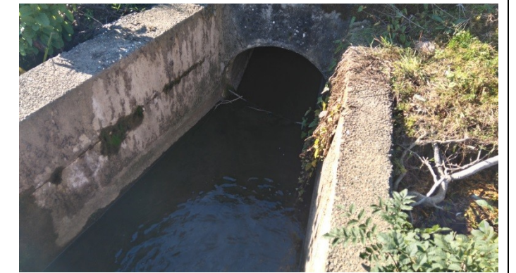
Canalisation de trop plein DN800
