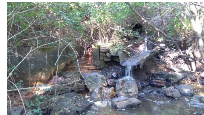
Arrivée de la canalisation de trop plein DN800
